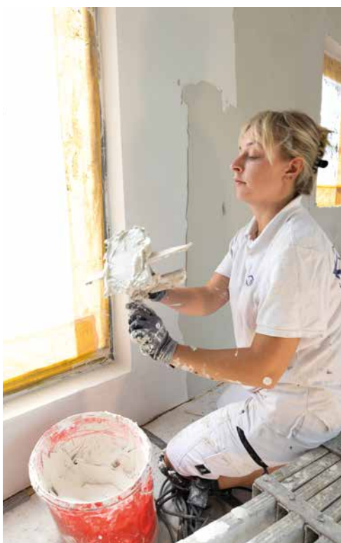
Fachgerechte Arbeit: Die mit den Dämmplatten versehene Wand wurde mit PP Fill fachgerecht verspachtelt.
